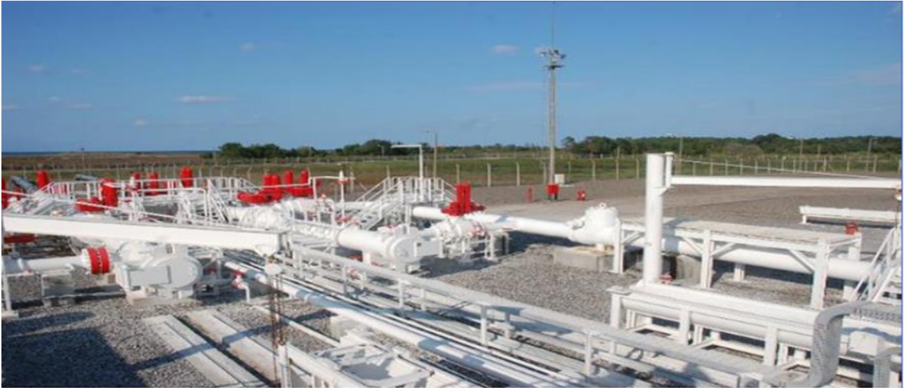
Şekil 6 – Tamamlanmış bir Alım Terminali görüntüsü
