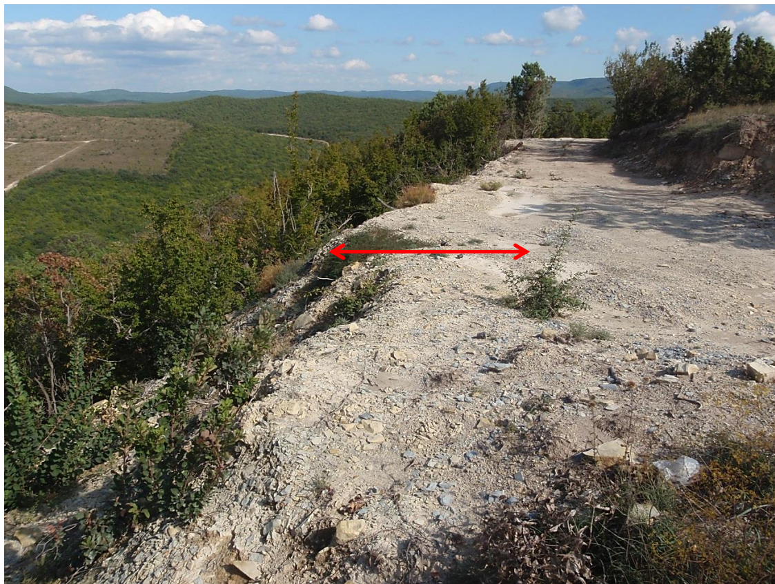
Фото 8 Подъездная дорога, примыкающая к площадке 4 на вершине хребта (красной стрелкой обозначен участок, нуждающийся в рекультивации)
