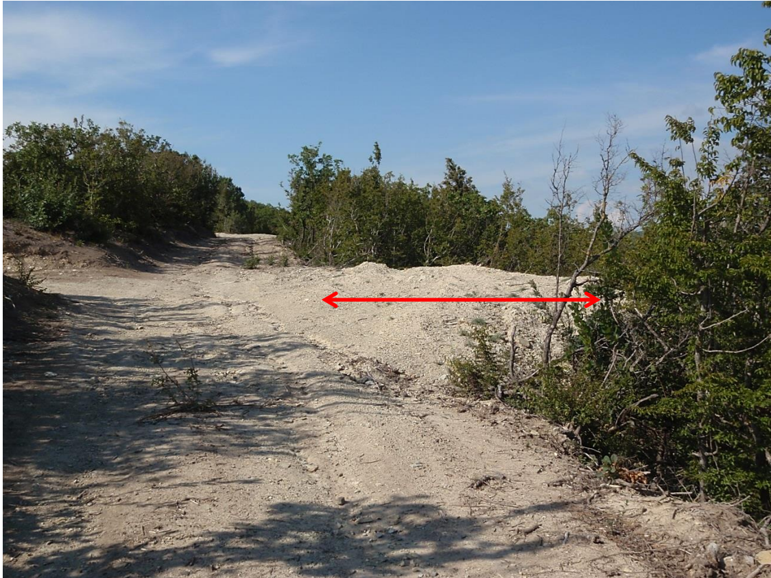
Фото 7 Подъездная дорога, примыкающая к площадке 2 на вершине хребта (красной стрелкой обозначен участок, нуждающийся в рекультивации)
